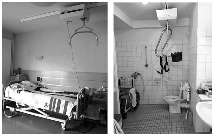
Figure 3 : Tous les appartements sont équipés d'un rail reliant la chambre et la salle de bain. Il permet l'utilisation d'un lève-personne au plafond équipé soit d'un filet soit de pinces.
